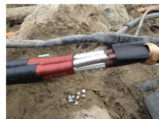
Herstelling van een defect op een oude HS-kabel met een stuk nieuwe HS-kabel
